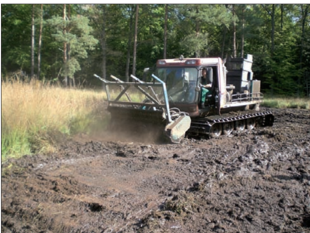
Einsatz der Moorraupe mit Forstmulcher zur Beseitigung der Pfeifengras-Bulten und Baumstümpfe (September 2012)
